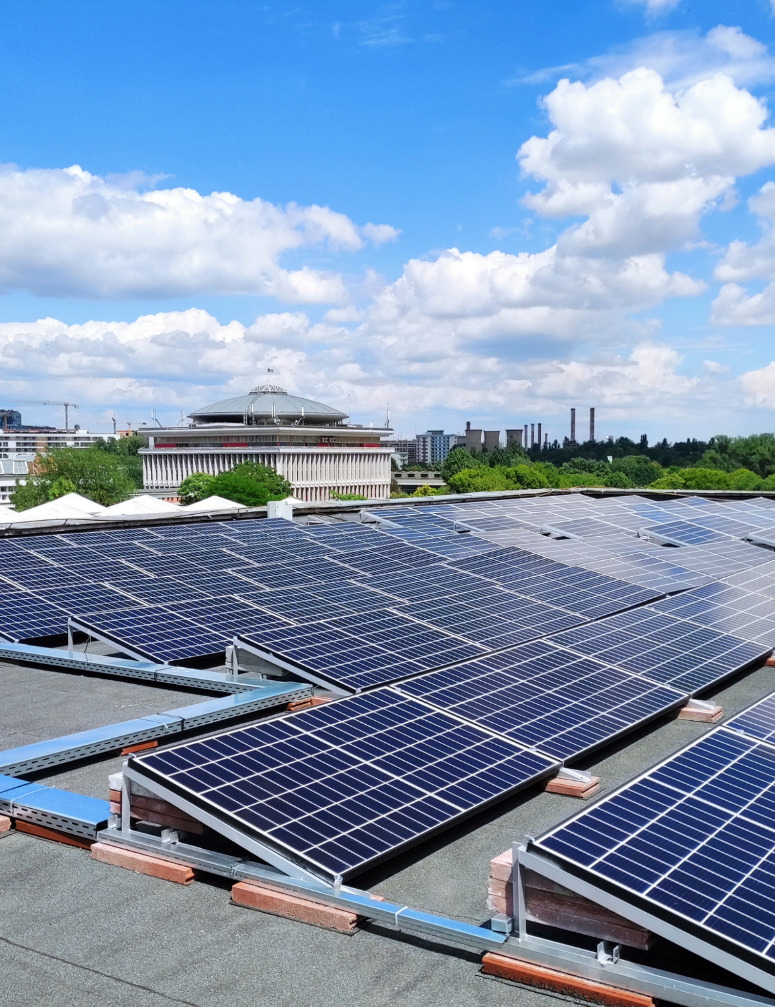
Sistem de panouri fotovoltaice pentru alimentarea cu energie electrică a sistemului termic, Laboratorul de Surse regenerabile de energie (Sistem hibrid de producere și distribuție a energiei termice, care utilizează doar surse regenerabile de energie, www.wedistrict.eu/demonstration-cases/bucharest/ )
