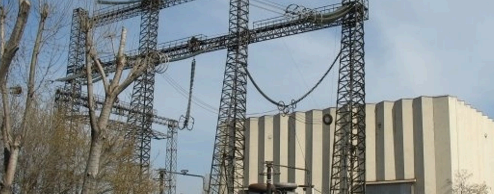
Laboratorul de Tehnica Tensiunilor Înalte -platforma exterioară
